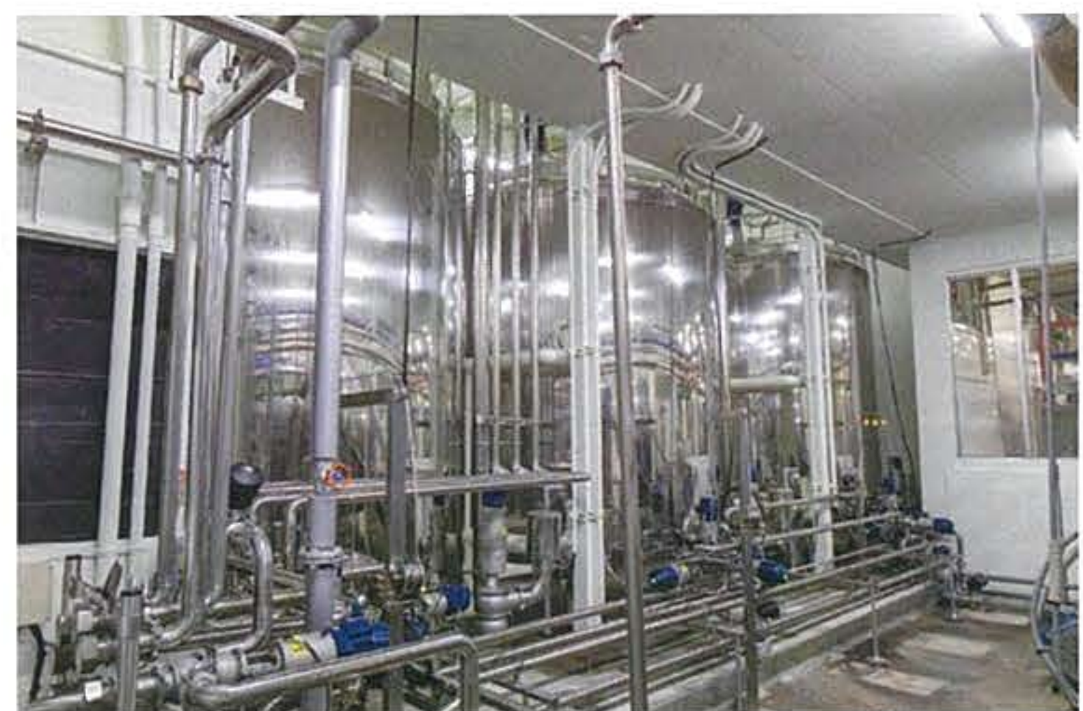
▲最近、入れ替えを行った充填前の牛乳を貯蔵するタンク、1基で10t貯蔵できます。
